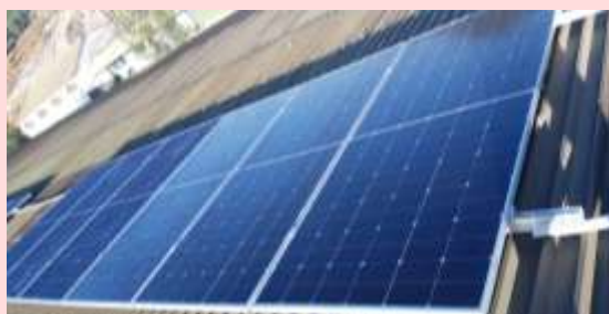
Foto 68: Instalación Placas Solares Autoconsumo. Zarandas
